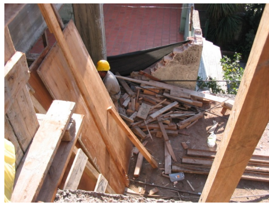
Imagen 3: Riesgo de caída a nivel. Fuente: Registro fotográfico arq. M. Mercuri
