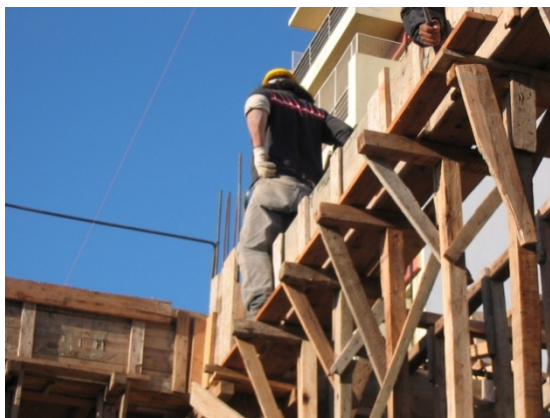
Imagen 2: Riesgo de caída en altura. Fuente: Registro fotográfico arq. M. Mercuri
